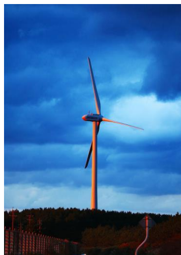
2,100kW 風力発電システム「HTW2.1-80A」 (秋田天秤野風力発電所)
